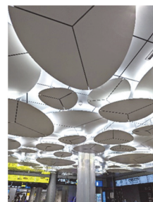
うめきた地下口コン コース上部の照明
